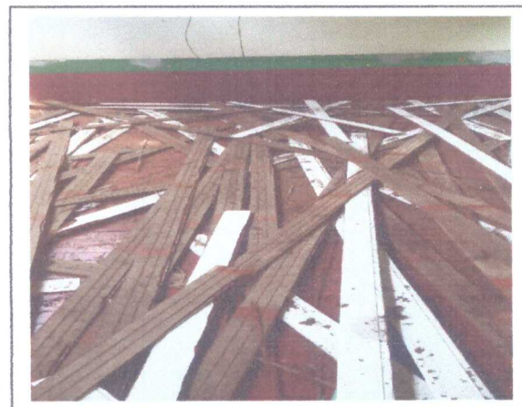
ARRANCAMENTO FORRO MADEIRA
