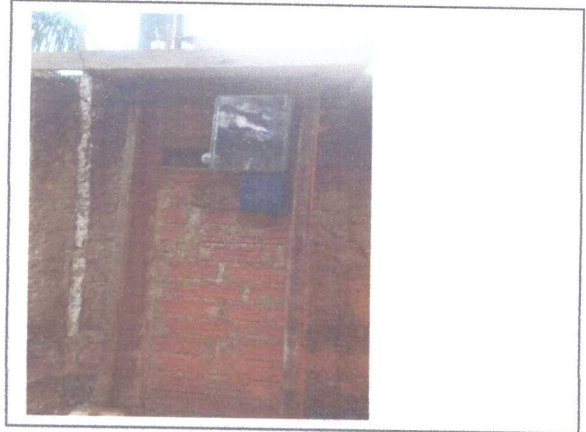
ENTRADA DE ENERGIA
